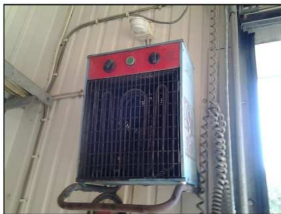
Bild 1. Elvärmefläkt på 9 kW för uppvärmning av tvätthall.
