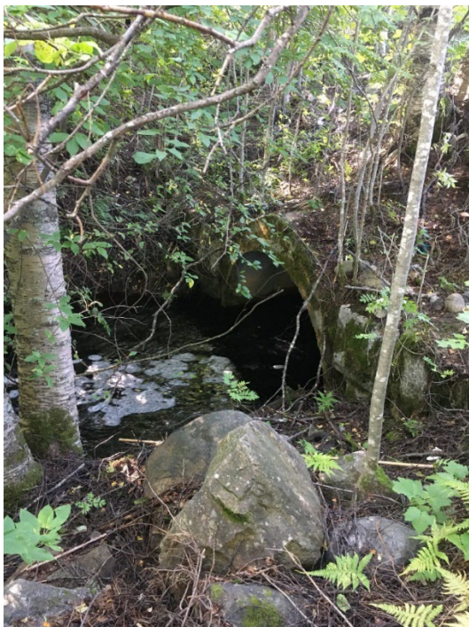
Figur 27. Trumma i Öxbäcken under Kungsvägen. (Foto: WSP.)
