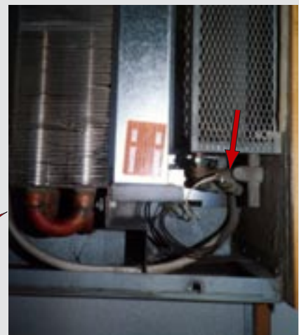
... där kvicksilvverippor finns monterade på reglerspjäll.
