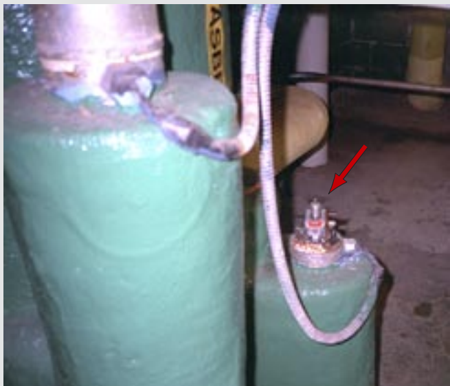
Tryckströmbrytare monterade på ammoniakbehållare.
