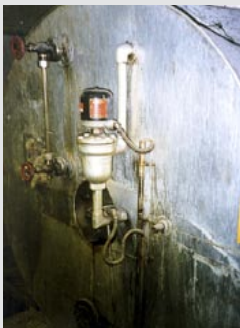
Tryckvakt monterad på tank. Fabrikat Magnetrol.
