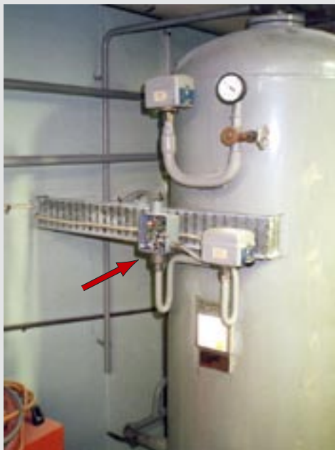
Tryckvakt monterad på tryckbehållare. Fabrikat Honeywell.
