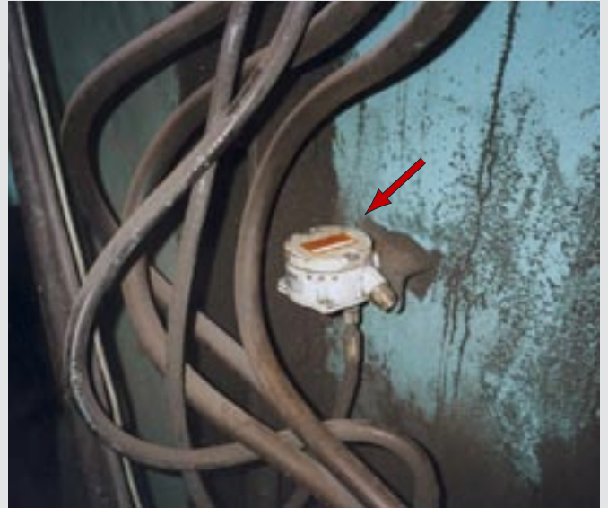
Varvtalsvakt. Fabrikat ASEA.
