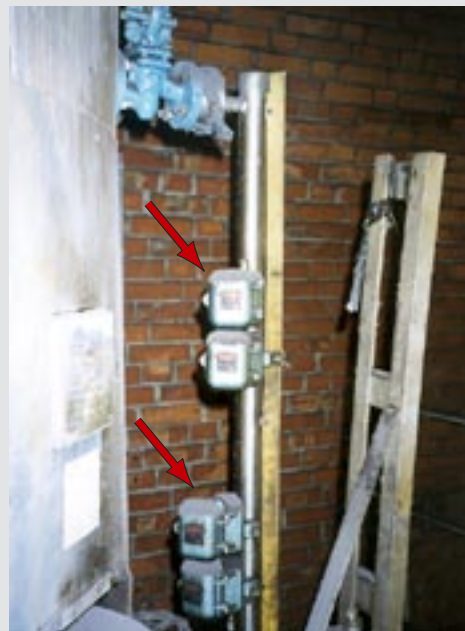
Nivåvakter monterade på tank. Fabrikat Ekström.
