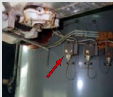
Termostater monterade för reglering i värmecentral.
