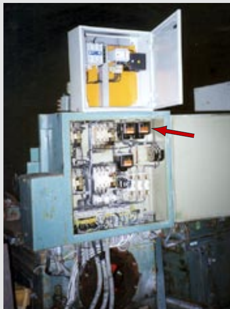
Tidrelän monterade i automatiskåp till industriugn. Fabrikat Siemens.
