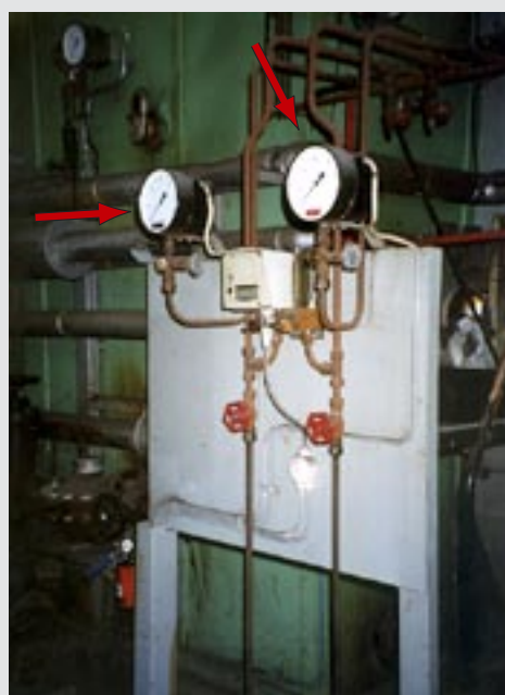
Tryckmätare monterade på tryckluftssystem för maskin. Fabrikat Siemens.
