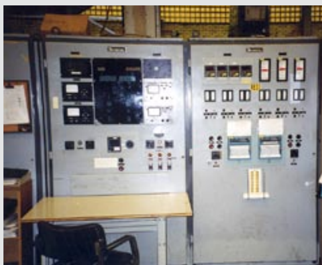
Automatiskåp för styrning av ugnar ...
