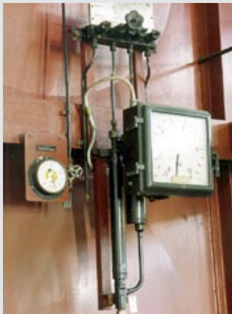
Flödesmätare. Fabrikat Siemens.
