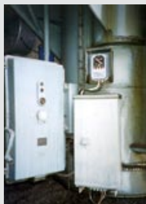
Temperaturvakt monterad på industriugn. Fabrikat Kihlströms.
