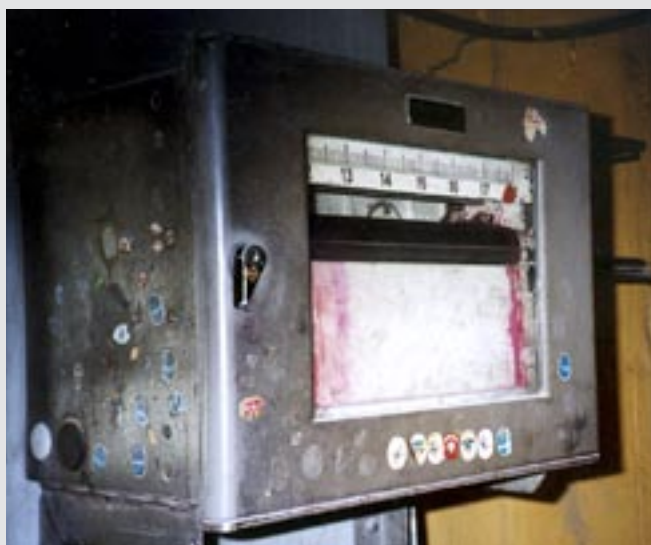
Nivåskrivare. Fabrikat Honeywell.
