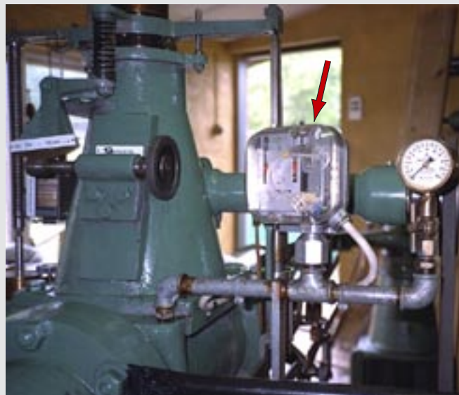
Tryckvakt monterad på kompressor. Fabrikat Sauter.
