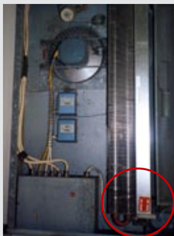
Friskluftsanläggning monterad på taket av en skola ...
