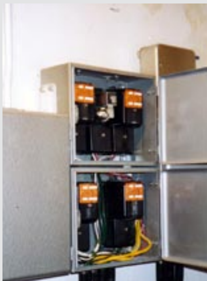
Trappautomater monterade i elskåp.
