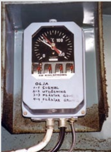
Temperaturvakt. Fabrikat Kihlströms.
