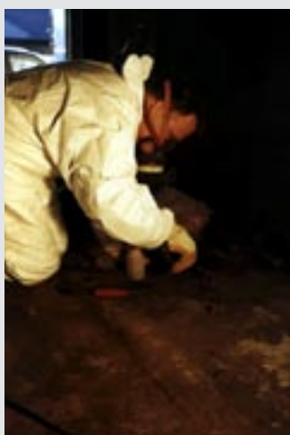
I äldre lokaler kan det förekomma kvicksilverspill som måste saneras.
