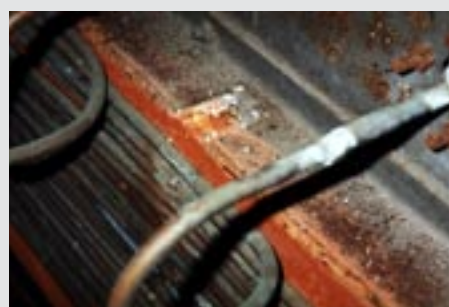
Rostigt kapillär rör
