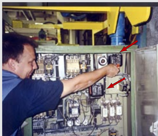
... i vilket tidrelä fanns monterat. Fabrikat Siemens.
