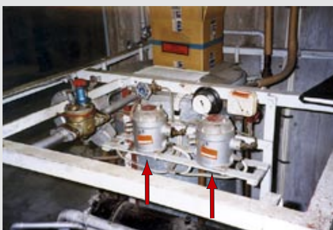
Explosionsskyddade tryckvakter monterade i gasanläggning. Fabrikat Sauter.
