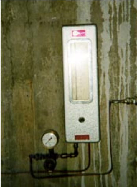
Volymmätare. Fabrikat Metro.
