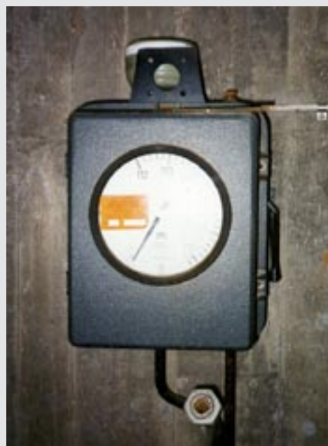
Flödesmätare. Fabrikat Wasser.
