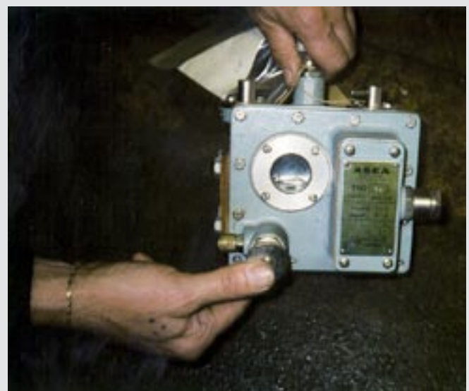
Gasvakt. Fabrikat ASEA.
