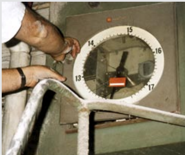
Nivåmätare. Fabrikat Honeywell.
