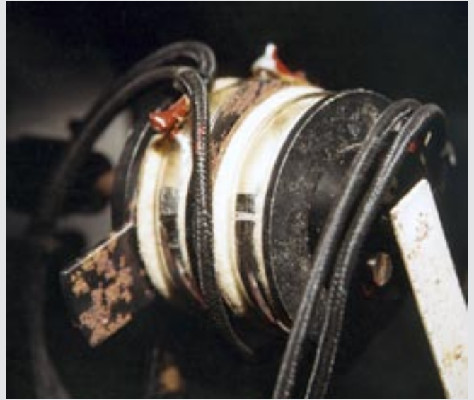
... innehållande kontaktringar. Fabrikat Schoppe & Faeser.
