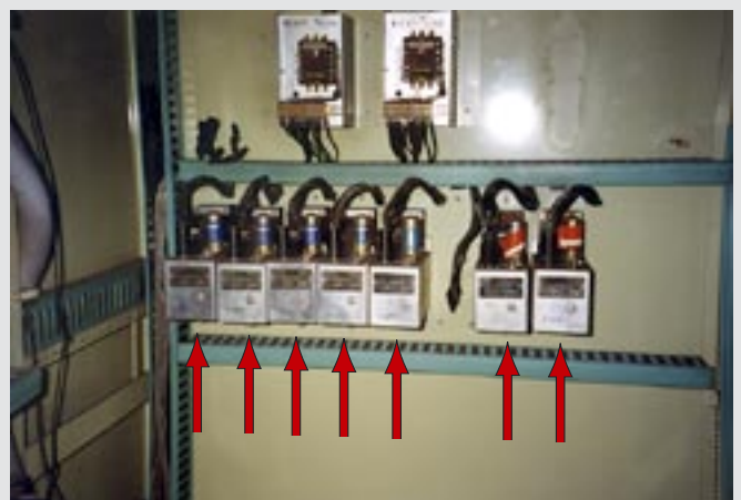
Relä med stiftkontakt för kontrollrumsstyrning.
