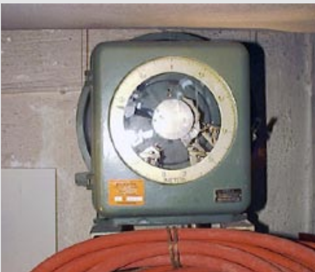
Nivåmätare. Fabrikat ASEA.
