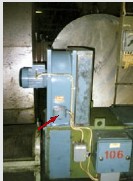
Varvtalsvakt monterad på elmotor. Fabrikat ASEA
