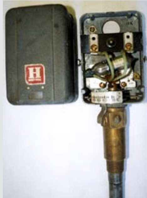
Termostat med vippa och nedåtriktat dykrör i vilket kvicksilver kan finnas. Vanligt förekommande på oljepanna. Fabrikat Honeywell.
