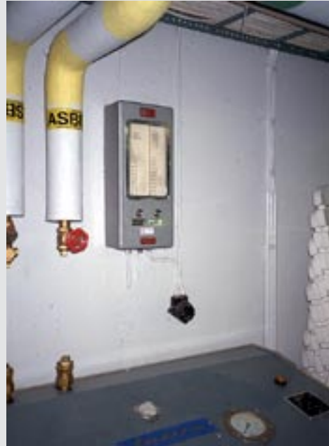
Volymmätare. Fabrikat Metro.
