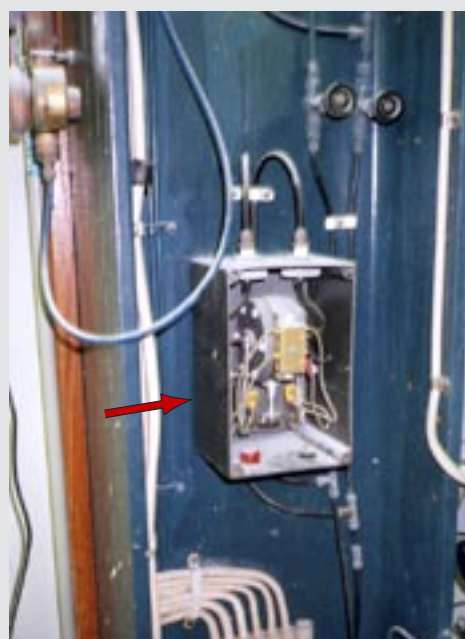
Tryckvakt med kvicksilverbrytare monterad i doseringsrum för vattenrening. Fabrikat Wallace & Thernan.
