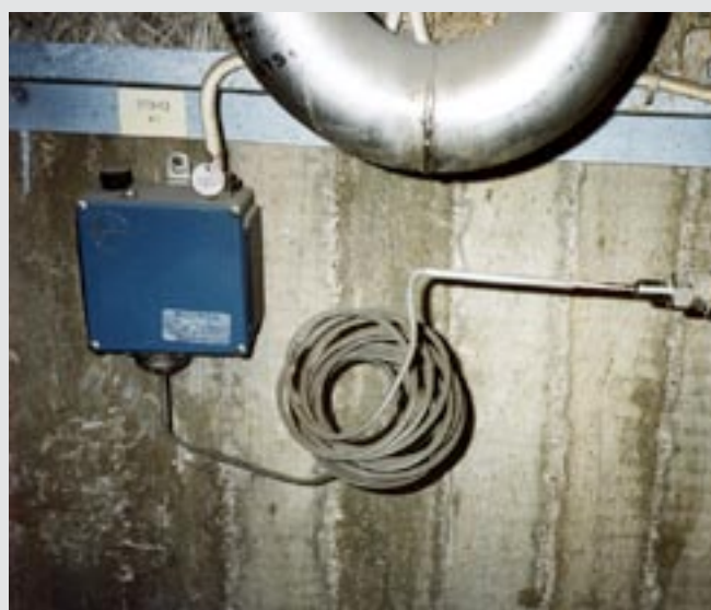
Termostat med kapillärrör. Fabrikat Billman.
