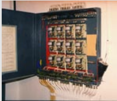
Reglerutrustning för ventilationsanläggning med monterade reläer.
