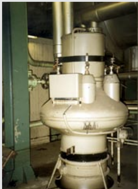
6-anodig jonventil. Fabrikat Brown Boveri.
