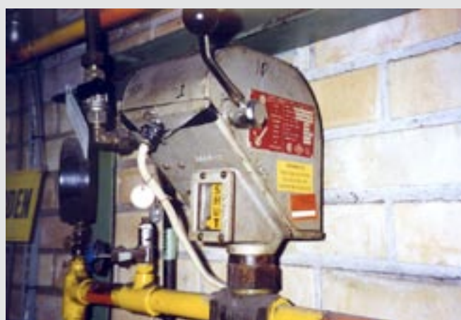
Tryckvakt monterad i gasanläggning. Explosionsskyddad. Fabrikat North American Safety Valves.
