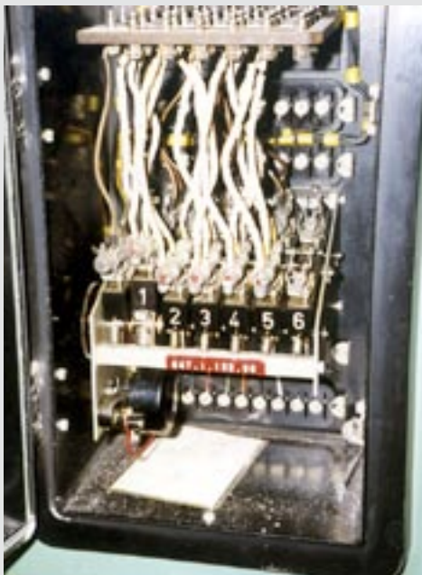
Temperaturreglering med räkneverk.
