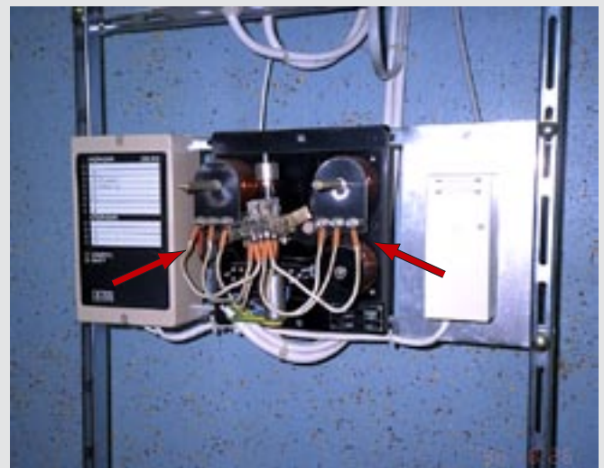
Blinkdon monterad i signalutrustning för t.ex. järnvägsövergång. Fabrikat Dansk Signalindustri.
