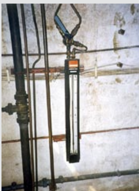
Nivåmätare med pelarvisning. Fabrikat Siemens.
