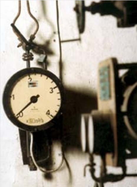
Flödesmätare. Fabrikat Siemens.
