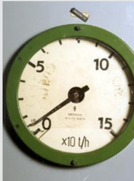
Flödesmätare. Fabrikat Siemens.
