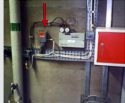
Pressostat monterad i ventilationsanläggning.
