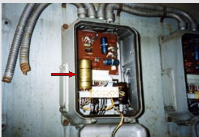
Relä med stiftkontakt för maskinreglering. Fabrikat Elliot.
