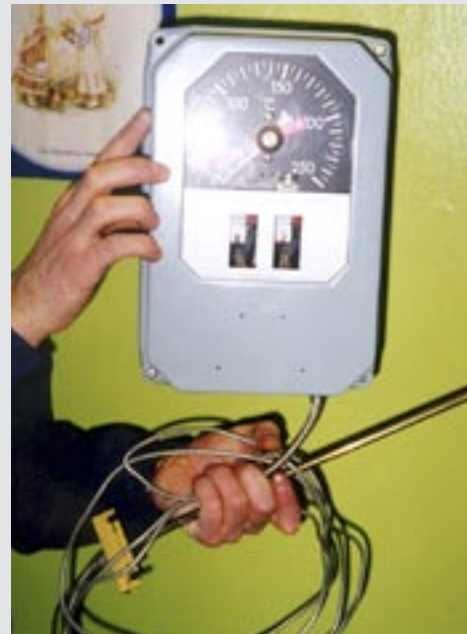
Temperaturvakt. Fabrikat Kihlströms.
