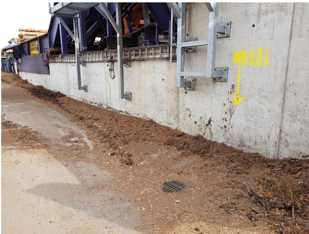
Figur 5. Dagvattenbrunn i den centrala delen av timmerplanen.
