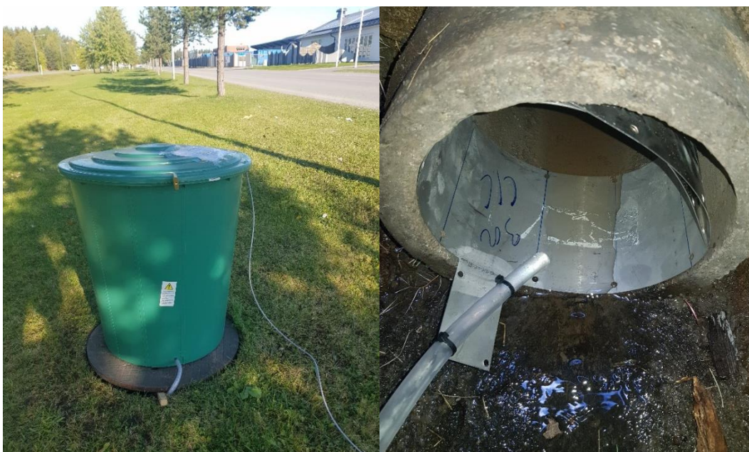
Figur 17. Exempel på väderskydd placering av provtagaren på provtagningsbrunn samt installation av slangen i ledningen.
