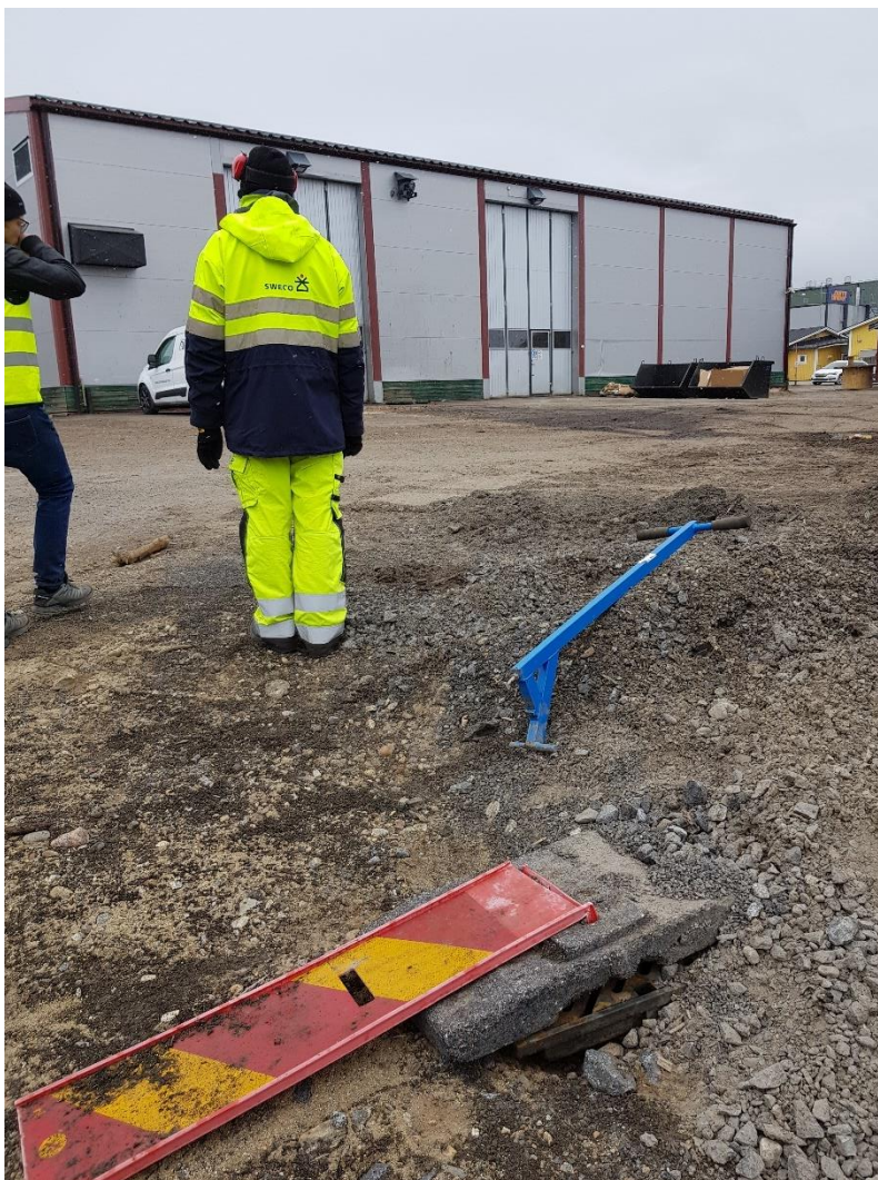
Figur 12. Dagvattenbrunn på Sävar 13:44, blick mot verkstad.
